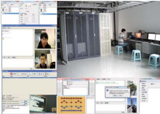
部署机房现场及部分业务功能界面图
